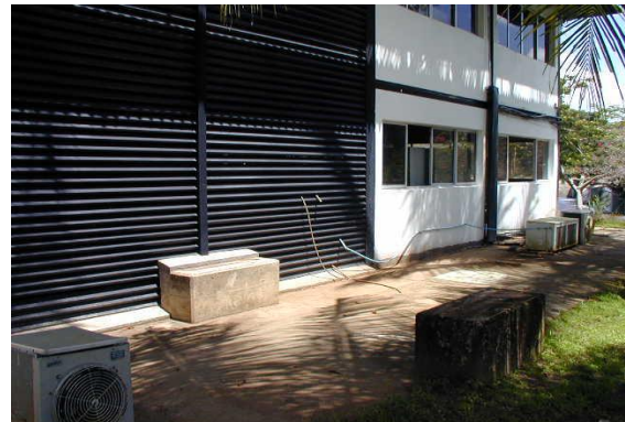
Entrada del Sistema de Bombeo
