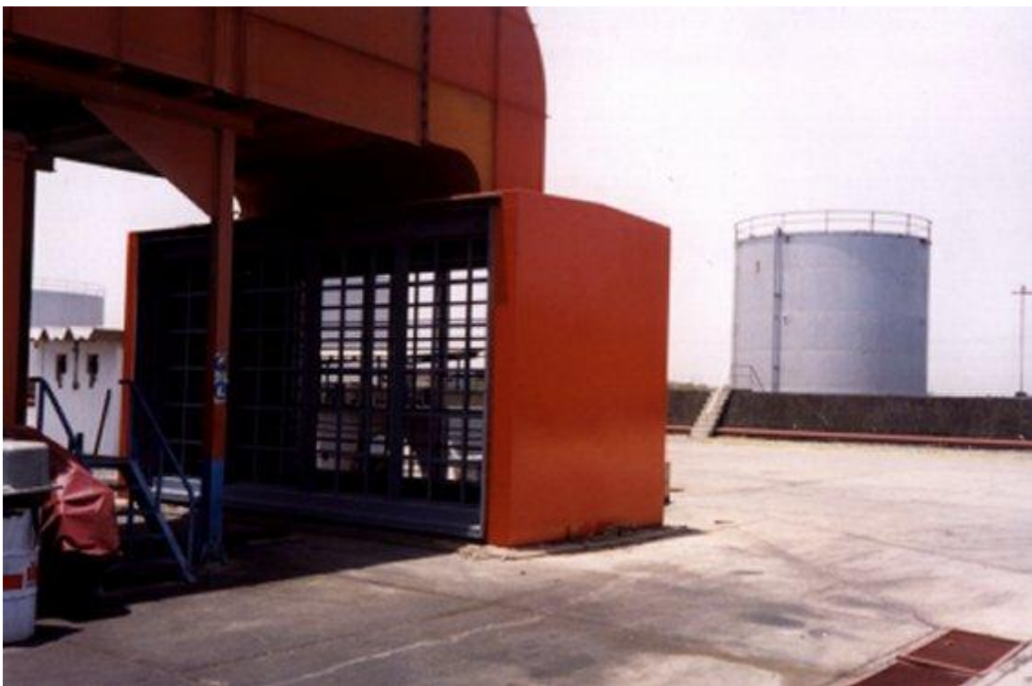
Fig. 5.2 Unidad N° 7, casa de filtros en mantenimiento mayor
