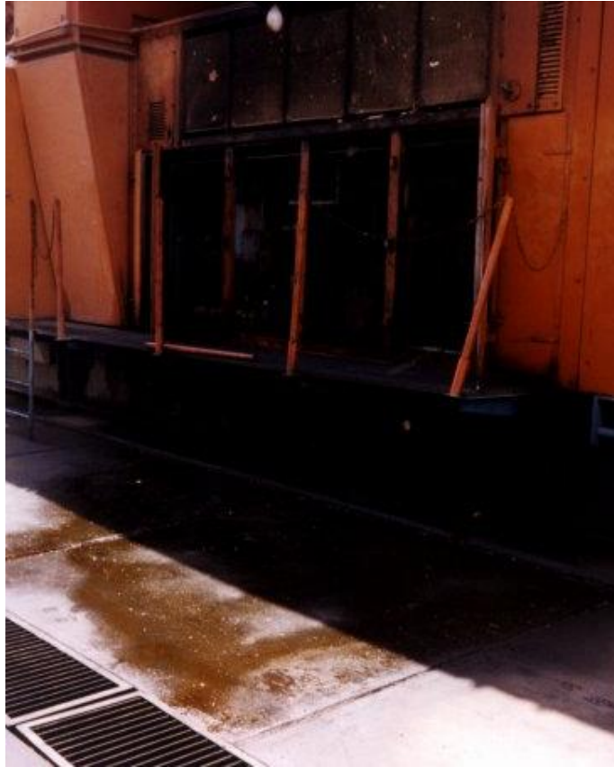
Fig. 5.7 Unidad N° 12, fuga de lubricante a nivel del compartimento de accesorios
