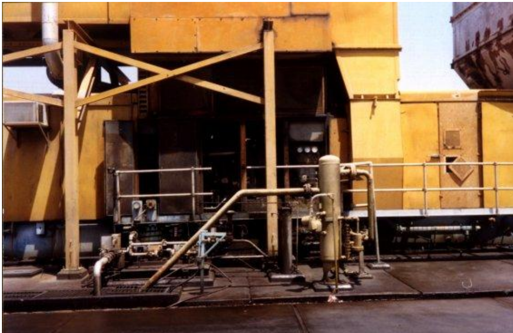
Fig. 5.8 Unidad N° 10, fuga de combustible en el compartimento de accesorios
