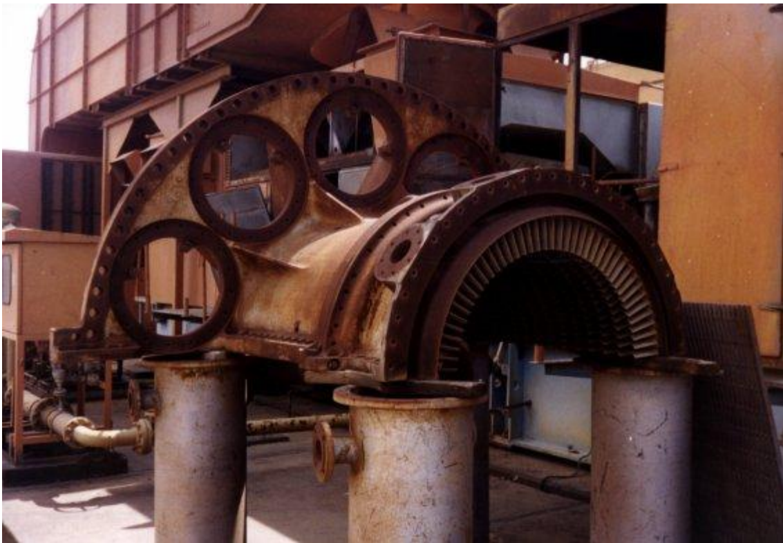
Fig. 5.4 Unidad N° 11, carcasa posterior del compresor y cestos combustores
