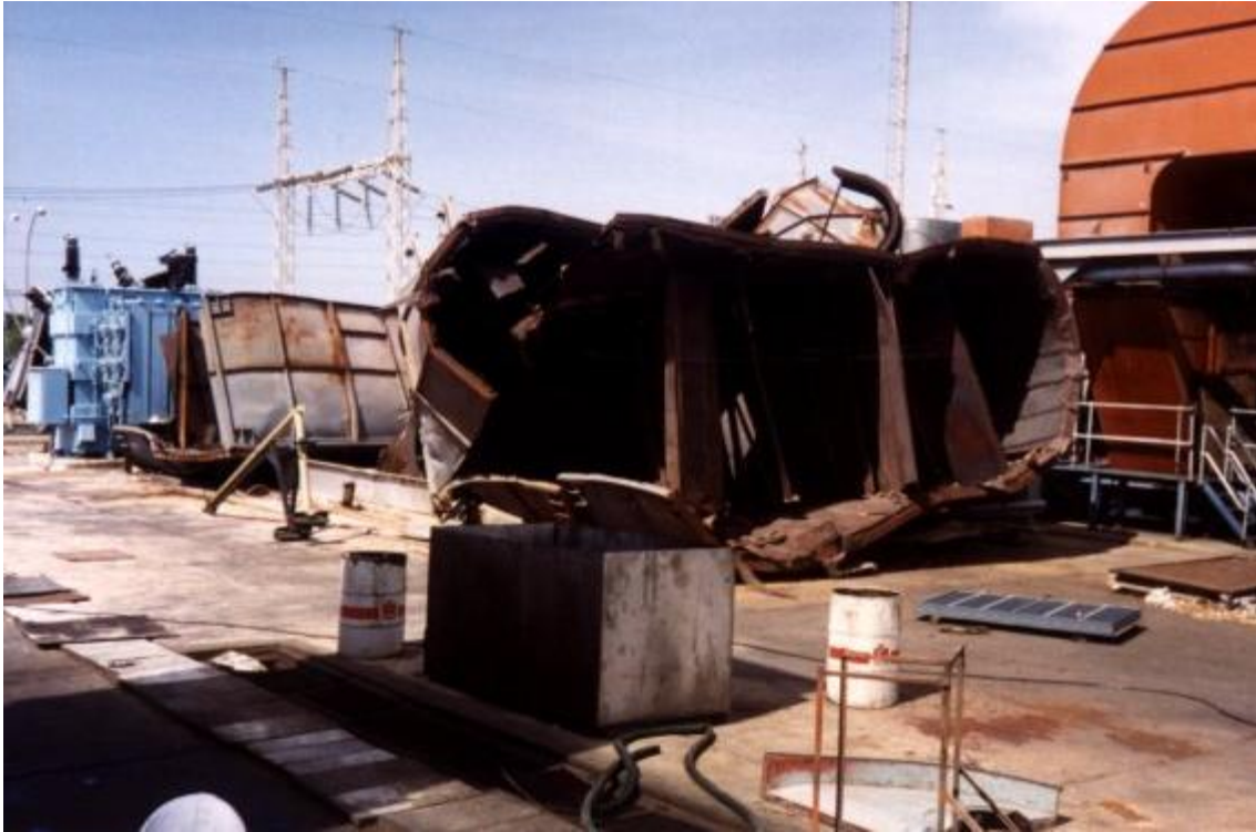
Fig. 5.3 Unidad N° 14, luego de la explosión del plenum de escape
