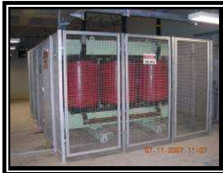
Fig. 1. 8.- Transformador seco (30 kVca → 630 Vca) Líneas 3 y 4 perteneciente a Metro de Caracas C.A.
