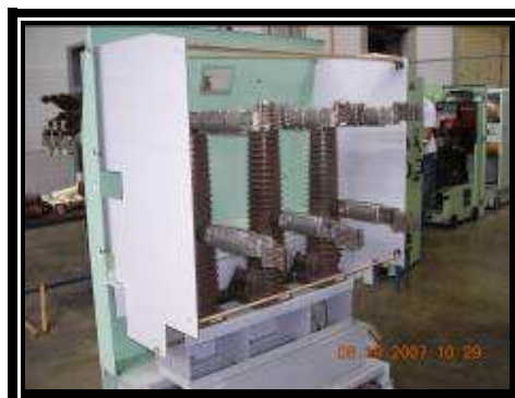
Fig. 1. 5.- Disyuntor de 30 kVca Líneas 3 y 4 perteneciente a Metro de Caracas C.A.
