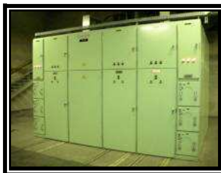
Fig. 1. 6.- Tablero disyuntor de 30 kVca perteneciente a Metro de Caracas C.A.
