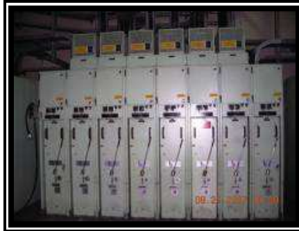
Fig. 1. 13.- Tablero disyuntor de 750 Vcc perteneciente a Metro de Caracas C.A.
