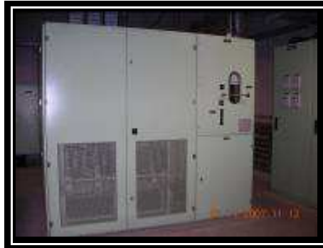
Fig. 1. 10.- Rectificador de potencia (630 Vca → 750 Vcc) Líneas 3 y 4 perteneciente a Metro de Caracas C.A.
