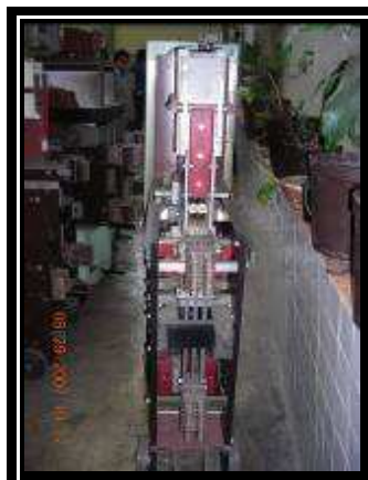
Fig. 1. 12.- Disyuntor de 750 Vcc Líneas 3 y 4 perteneciente a Metro de Caracas C.A.
