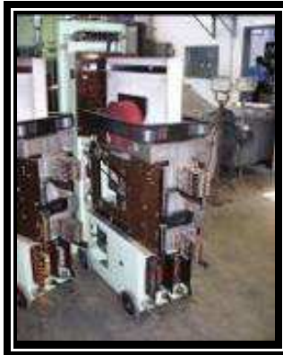
Fig. 1. 11.- Disyuntor de 750 Vcc Líneas 1 y 2 perteneciente a Metro de Caracas C.A.
