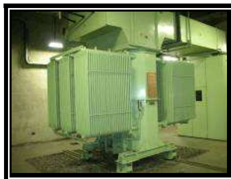
Fig. 1. 7.- Transformador sumergido en aceite (30 kVca → 630 Vca) Líneas 1 y 2 perteneciente a Metro de Caracas C.A.
