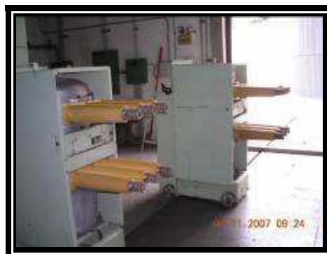
Fig. 1. 4.- Disyuntor de 30 kVca Líneas 1 y 2 perteneciente a Metro de Caracas C.A.
