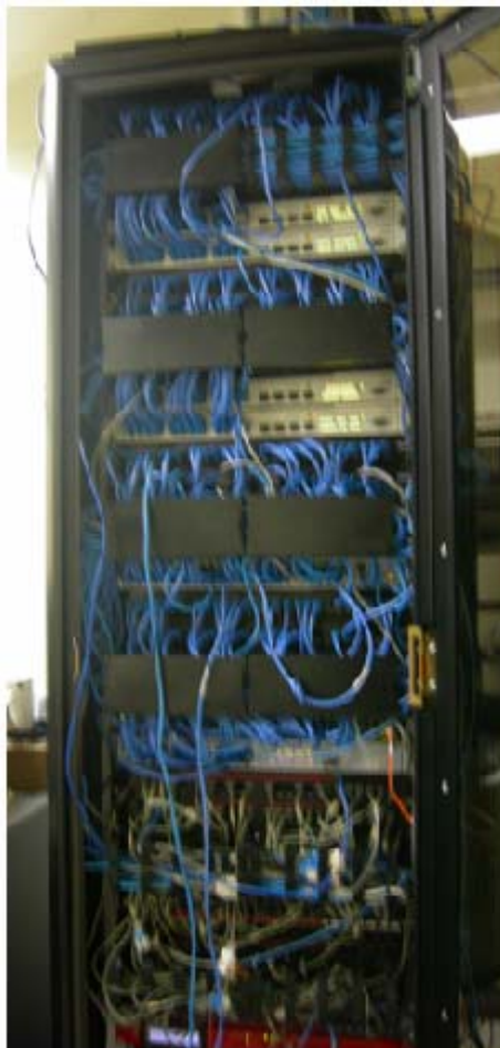
Armario de Racks
