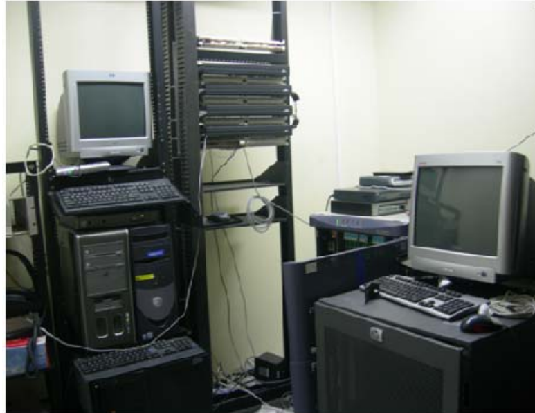
Sala de servidores
