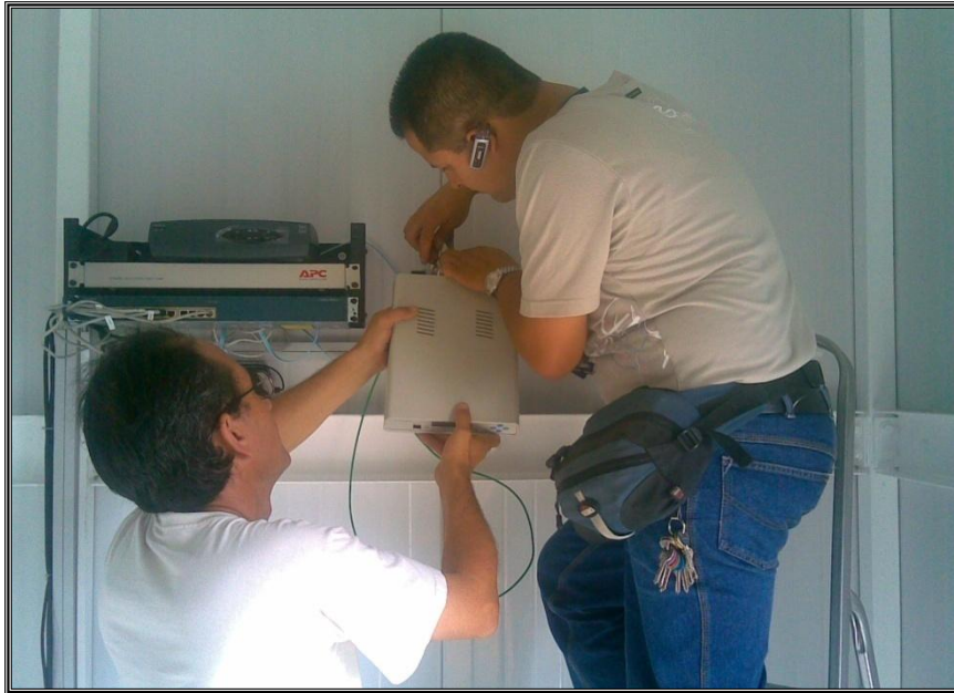
Ubicación de los equipos de comunicaciones en el shelter
