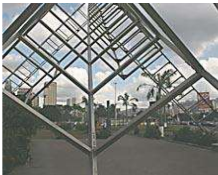
Pieza Desmantelada por vandalismo
